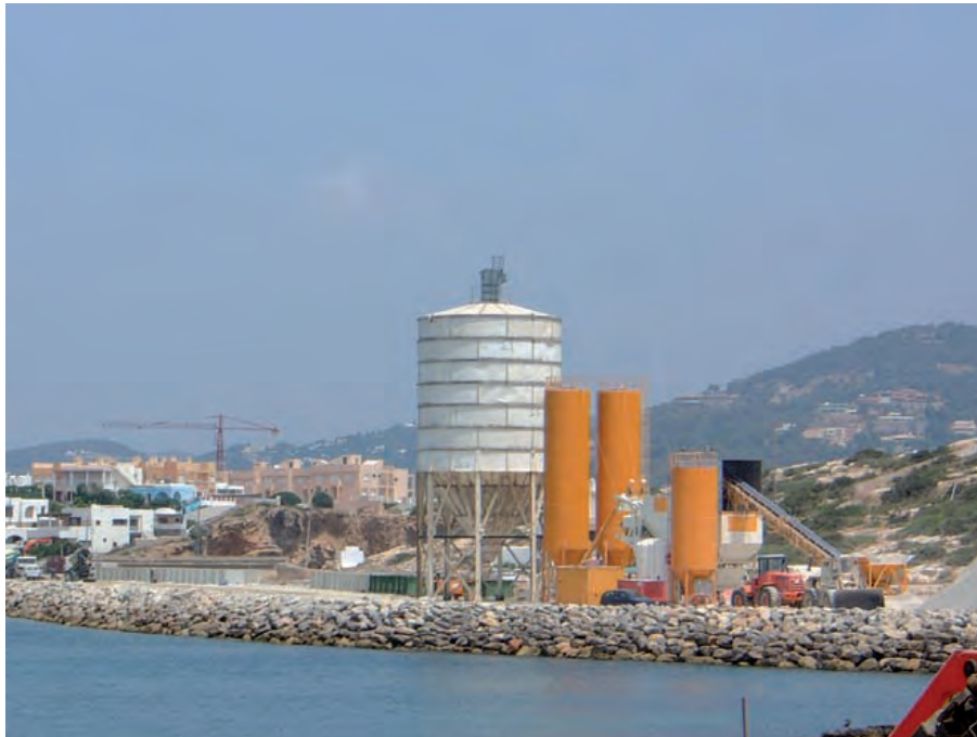
Figura 10.5.1 L Planta de hormigón
