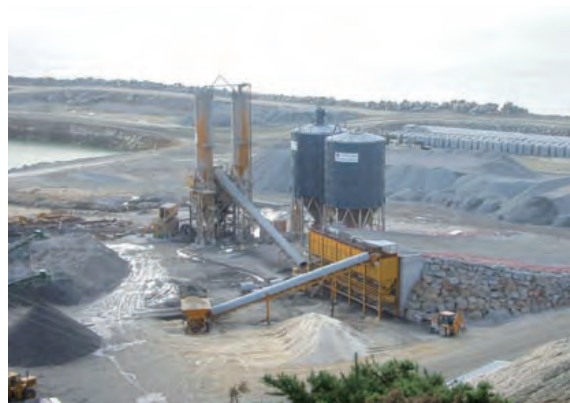
Figura 5.4 B Planta de fabricación de hormigón
