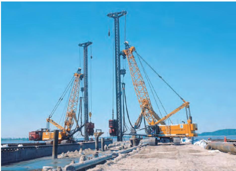
Figura 6.3.6 A Columnas encapsuladas
