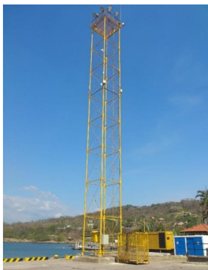
Figura 3. Torres de iluminación. Fuente: Elaboración propia.
