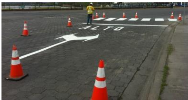
Figura 6. Señalización horizontal. Fuente: Elaboración propia.
